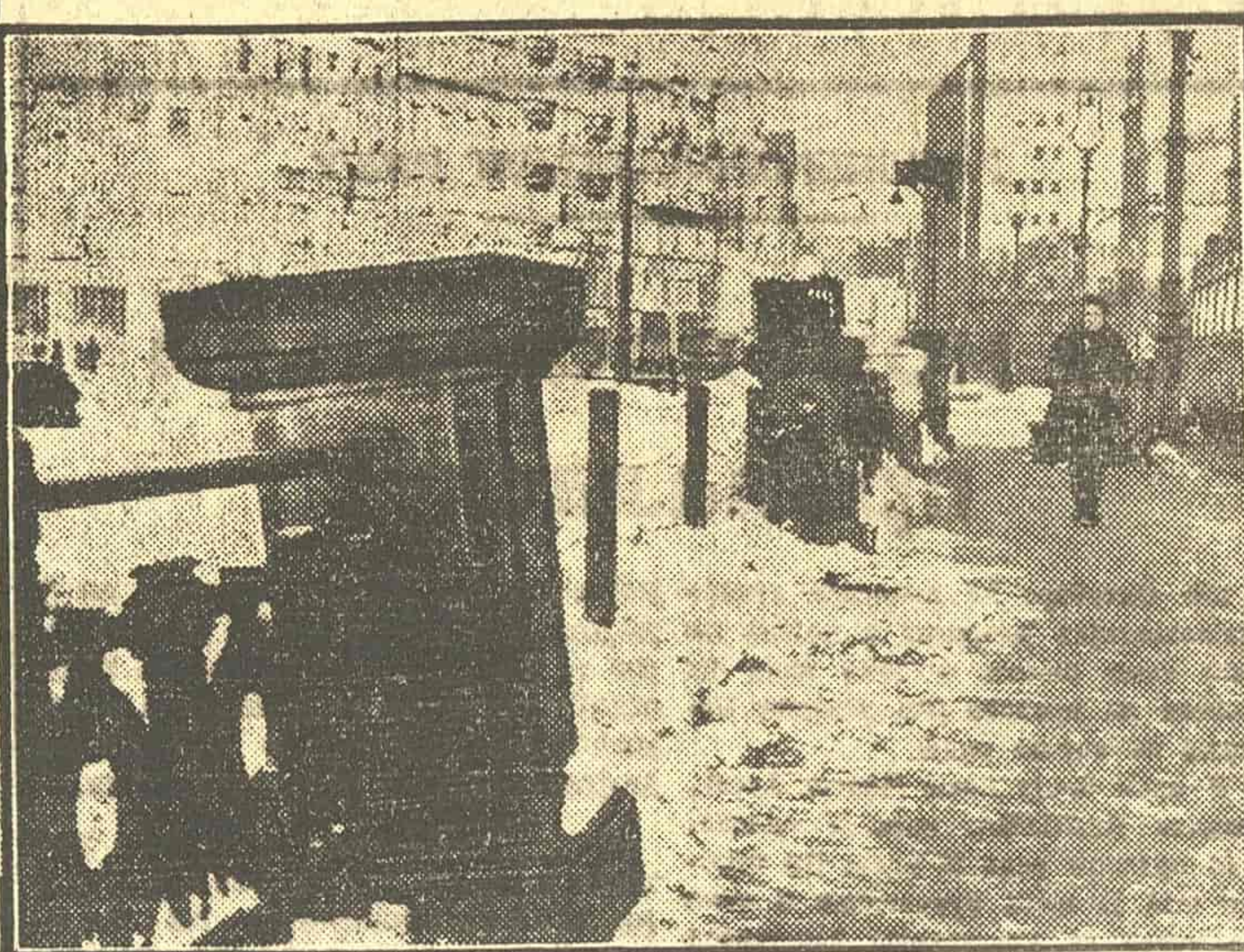
Разрушена ограда малих скверова на Терезијама квари изглед целога трга. На пролеће ће се ови скверови узалуд улепшавати цвећем ако и ограда не буде поправљена. Тај посао, међутим, изискује незнатна финансијска средства
