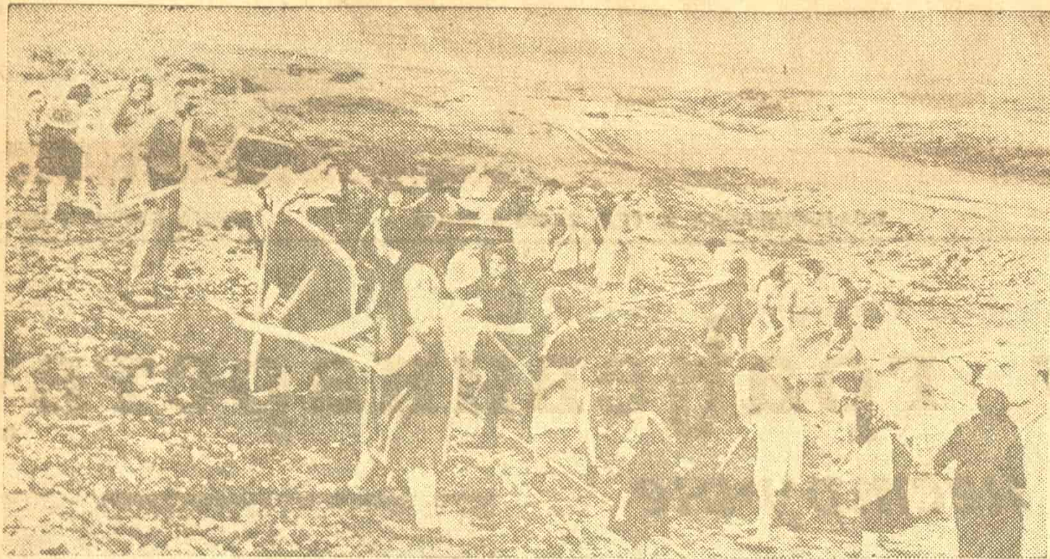
Синдикална подружница настојника из Првог рејона на добровољном раду на каналу стругаре „Буро Стругар“
